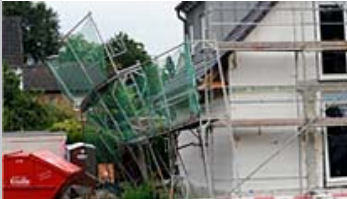
Neben einem Rohbau in Kamen ist ein Gerüst eingestürzt (Foto: dpa)
